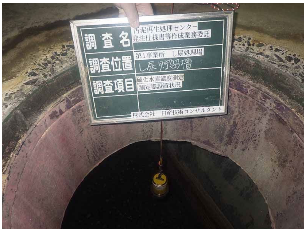
硫化水素測定器設置状況
