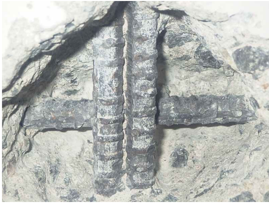
写真-4.1.7 投入前処理棟 H-K-4
