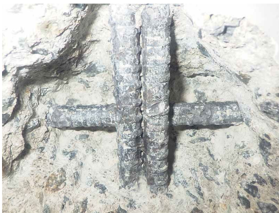
写真-4.1.9 投入前処理棟 H-K-6
